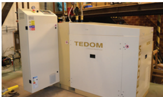
Jilemnice: Kogenerační jednotka umístěná v kotelně bazénu
