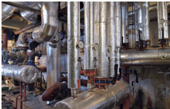
Výměňková stanice VS21 s novým centrálním výměňkem
