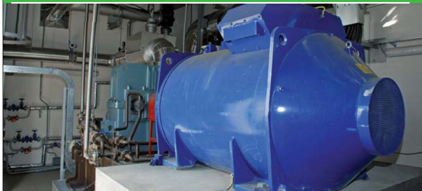
Turbogenerátor vyrobil již 12 tis. kWh elektřiny.
